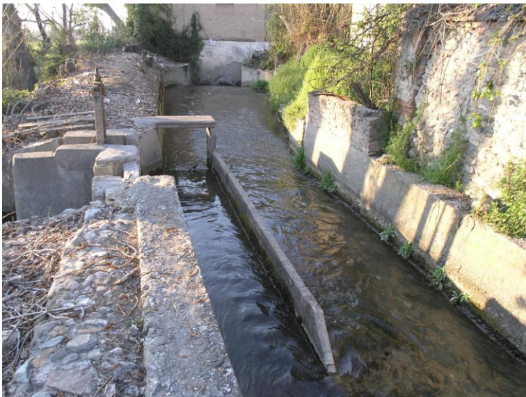
Fig. 3. Toma de agua de la Teja de la Huerta del Sagrado Corazón (Pago de Jaragüit Bajo, Acequia Gorda, Granada). ©José Castillo Ruiz
