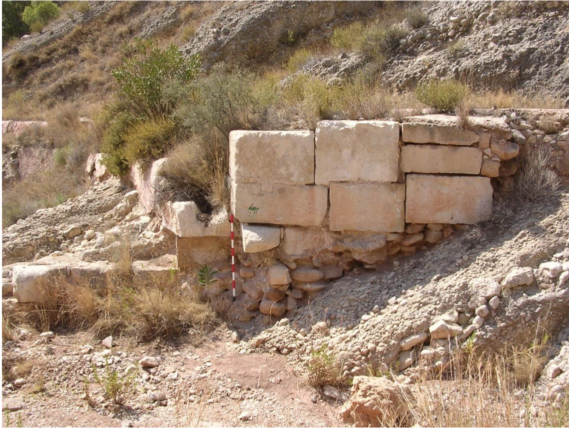
Fig. 2. Azud de La Tanca del Forat. Detalle del estribo occidental antes de la intervención.
