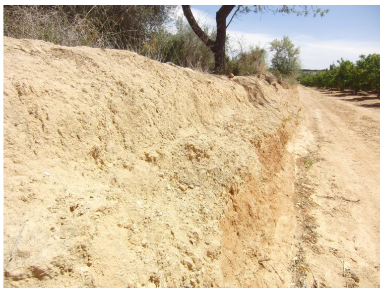
Fig. 4. Detalle de los restos de un tramo del cajero de la acequia, construida con una técnica de mortero de tierra y cal encajonada.
