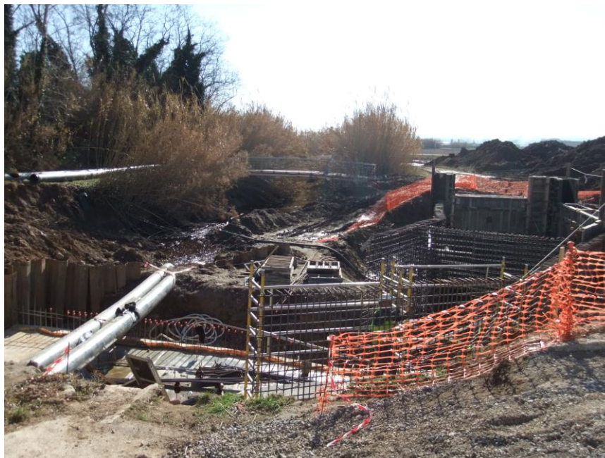
Fig. 5. Construcción de la nueva conducción para los riegos, a la derecha de la acequia histórica del Molí de Pals, en el punto de derivación de sus caudales respecto al propio río Ter (arbolado en la izquierda de la imagen). Mientras las obras se ejecutaban, unos tubos provisionales permitían que el agua continuara discurriendo por la acequia histórica a cielo abierto 6 .
