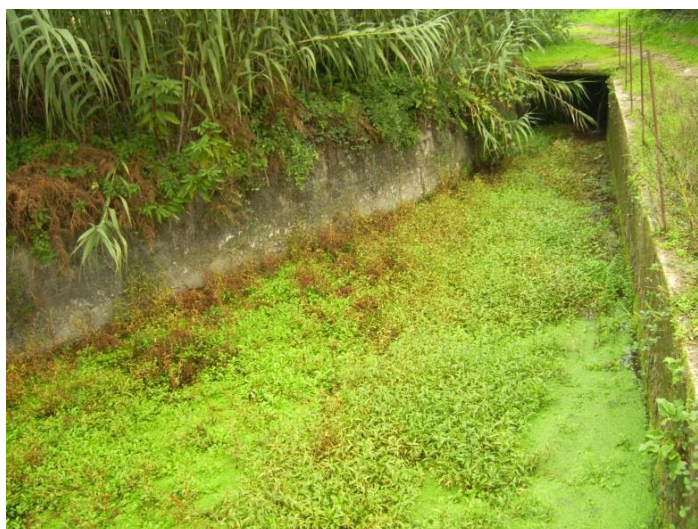
Fig. 6. Presa modificada enormemente, con muros actuales de hormigón y una parte de la misma soterrada bajo el camino lindante.
