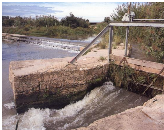
Fig. 3. Partidor en funcionamiento de la Acequia de Tormos, (Guinot y Selma, 2005, pp. 166).
